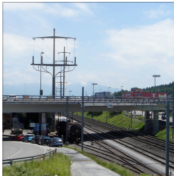
Abbildung 113: Blick in Richtung Osten von der Brücke zwischen Schweizerhof-Kreisel und Seedamm. Hinter der Brücke prägnant sichtbar ist die Anlage zur Verkabelung der Hochspannungsleitung. Im Vordergrund liegt das Anschlussgleis ins Industriegebiet Hurdnerwäldli (Foto: r.s., 2013).
